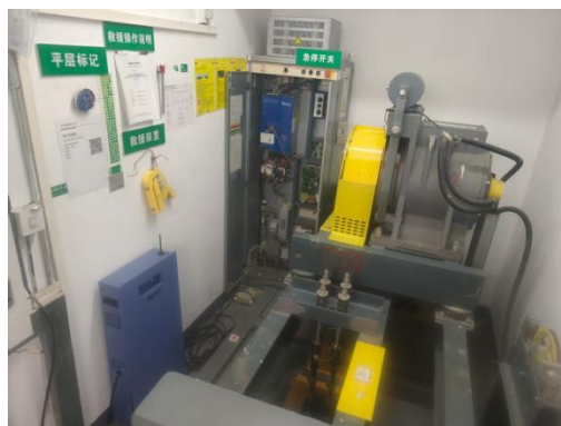
电梯（左）已安装电梯节能装置
