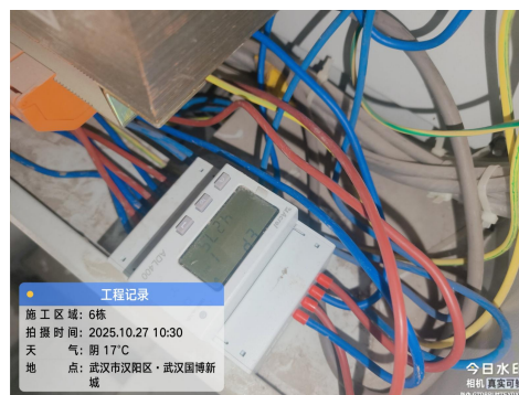
(图 4) 使用电梯节能装置第二次示数:1427.5 度电
