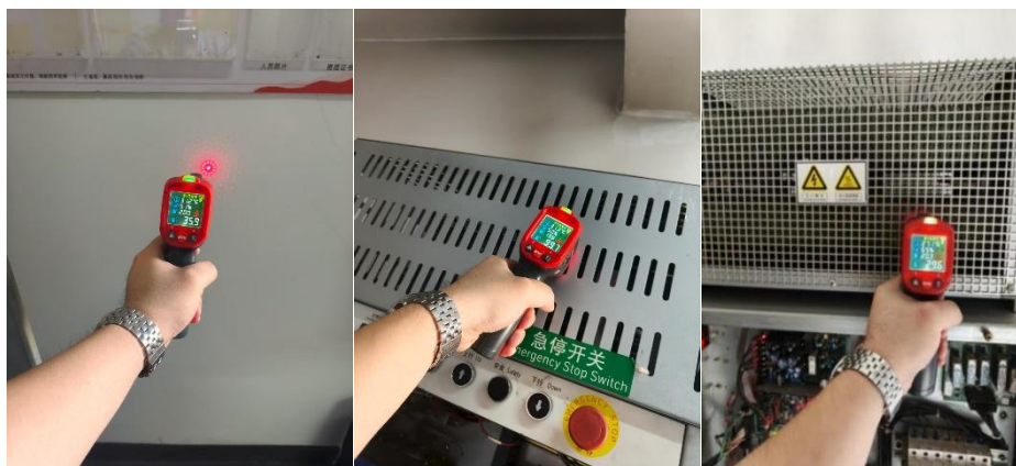
现场环境温度 35.9℃ 未安装电梯节能装置电阻温度 99.7℃ 已安装电梯节能装置电阻温度 29.6℃
