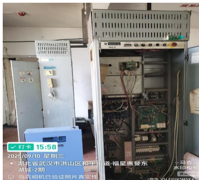
电梯已安装电梯节能装置
